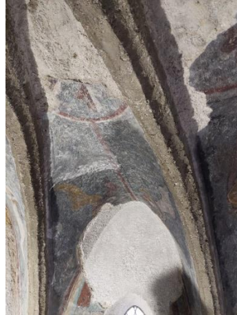
Deutlich erkennbar: Unterschied zw. verschmutzter und gereinigter Fläche
