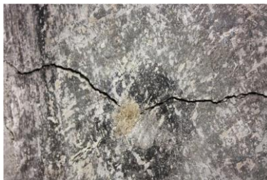
Rissbildung im Gewölbe des Chorraumes
